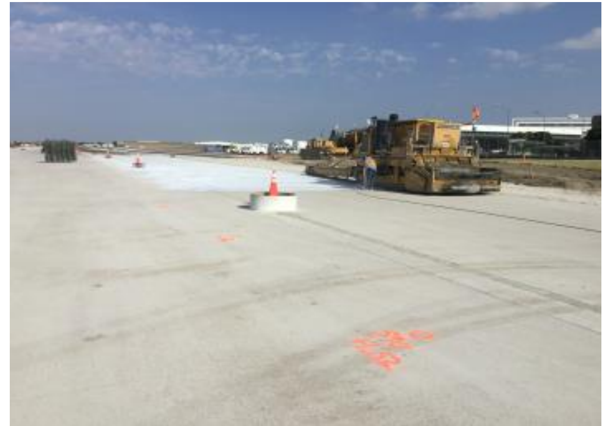
Figura 4 - TWY C con subcapa instalada, lista para la capa de hormigón final
