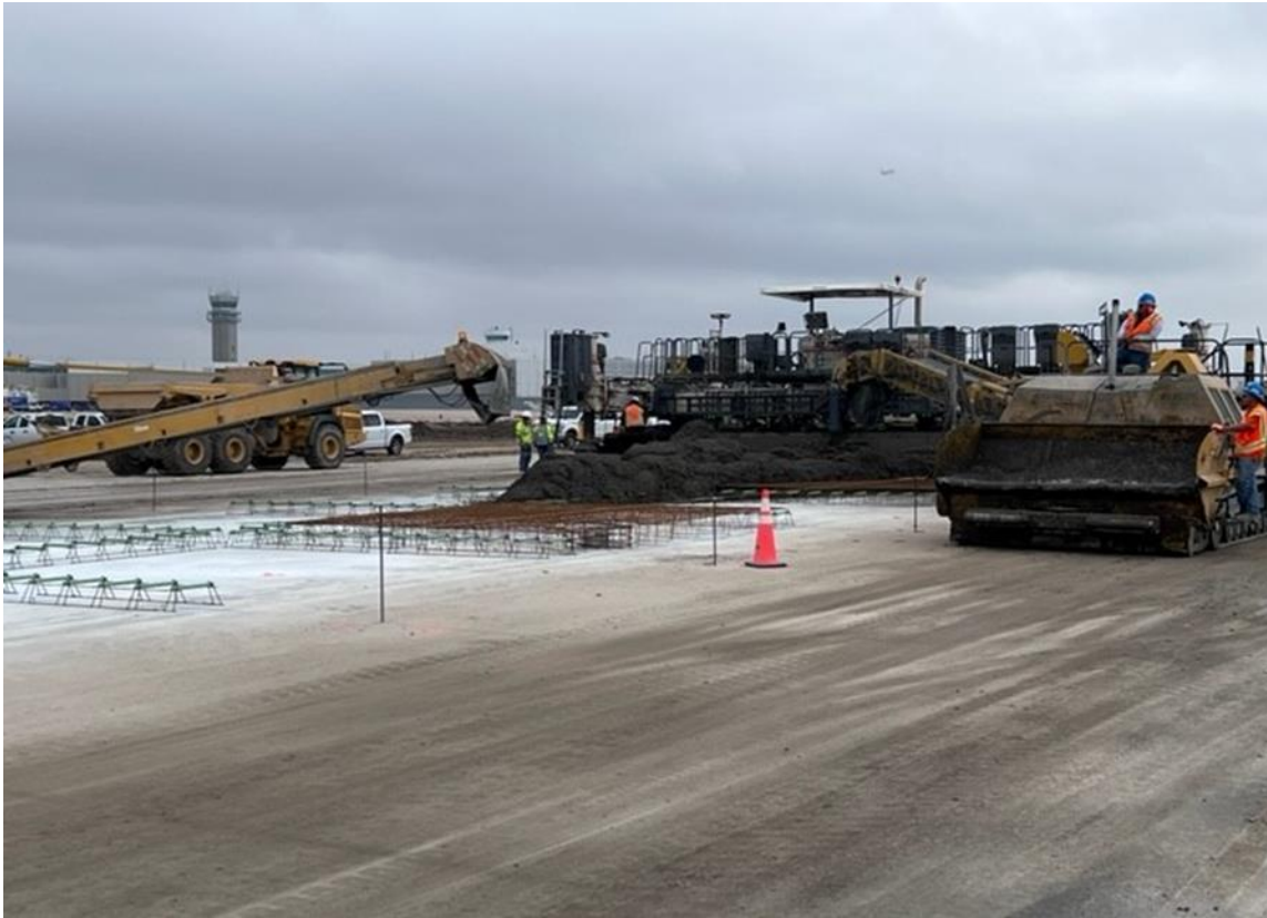
Figura 5 - RWY 13R/31L con refuerzos y colocación de la capa final del pavimento de hormigón
