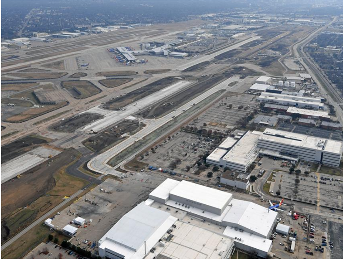
Figura 3 - Nueva TWY T en construcción (Fase 1) y mitad norte de la RWY 13R/31L en construcción (Fase 2)
